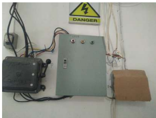
Gambar 4. Kondisi panel yang tidak standar PUIL 2000
