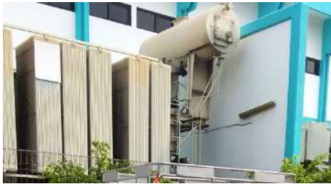
Gambar 1. Transformator pada GIS Cipinang
